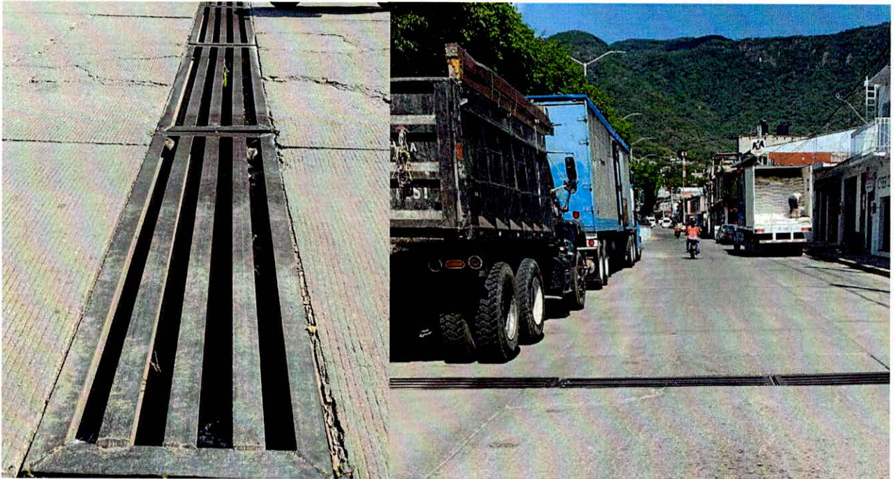
Ilustración 21 rejillas de drenaje pluvial.
