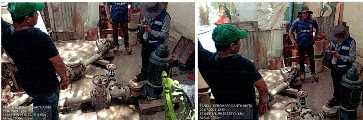
Ilustración 19.- Tanque Santa Anita.
