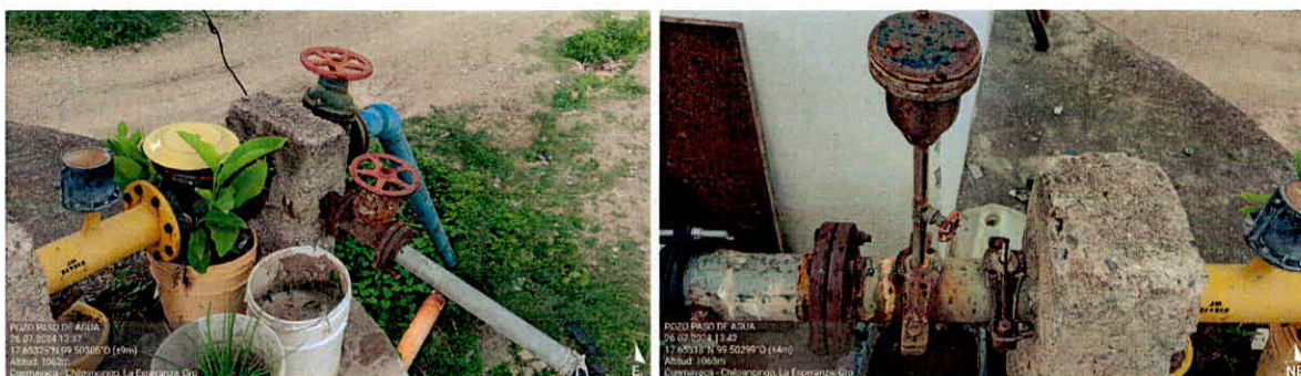
Ilustración 112.- Estado actual de trenes de descarga.
