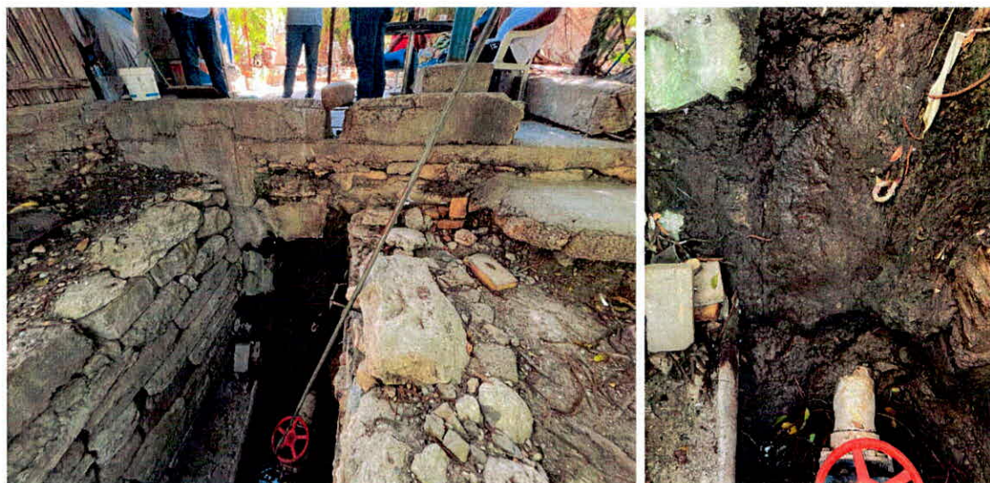
Ilustración 2.- Fugas en Tanque Alcantarilla.
