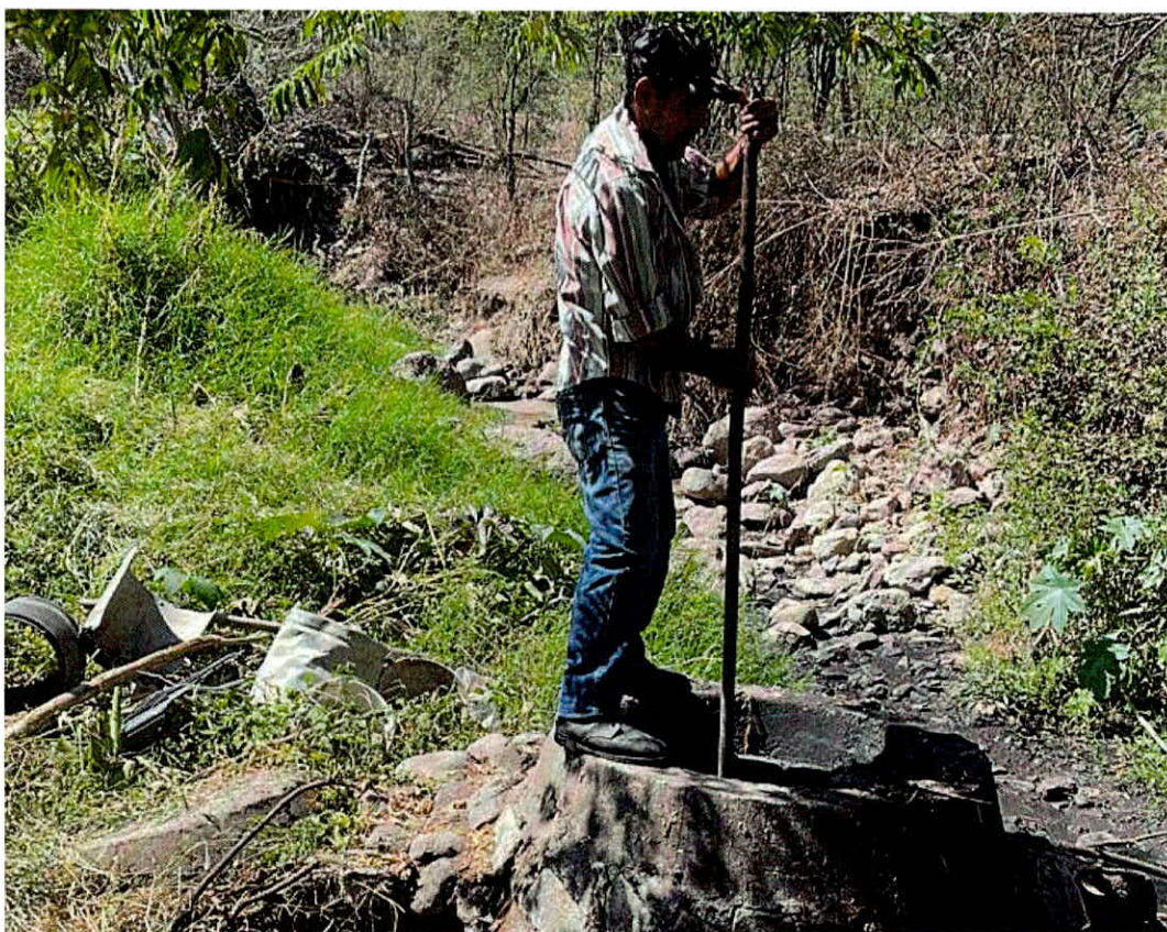
Ilustración 16 Línea de drenaje obstruida por azolve debido a la falta de tapa en la olla de drenaje.
